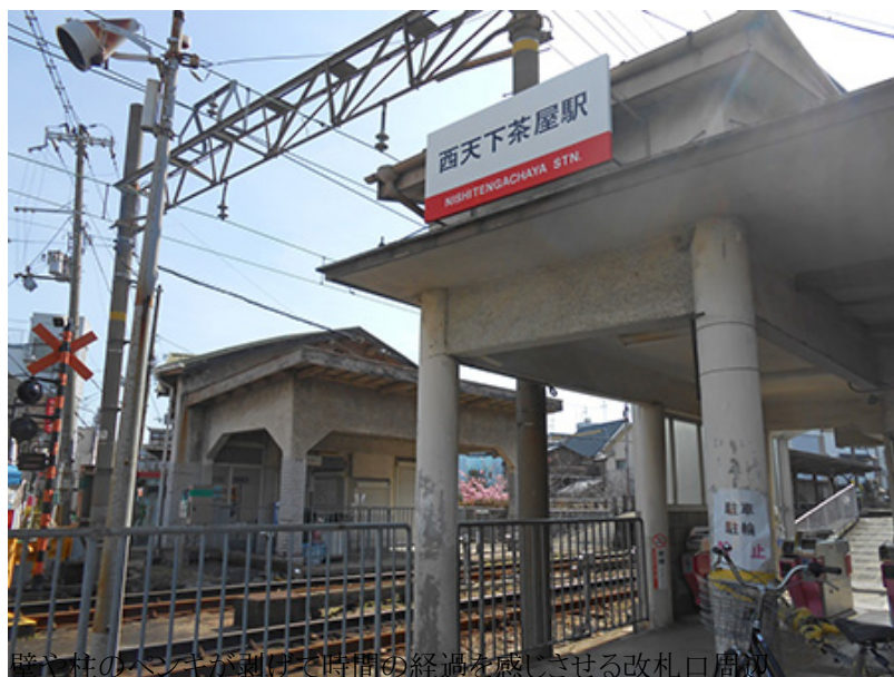
壁の柱のベンチが剥げて時間の経過を感じさせる改札口周辺
